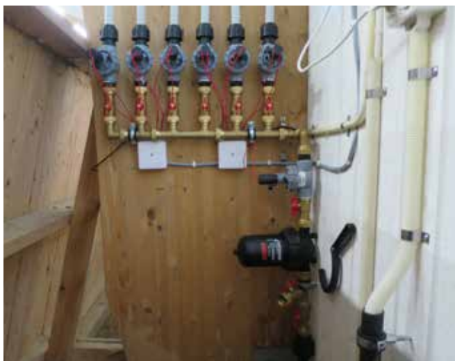
Ventilarrangemang till ridhusbevattning
