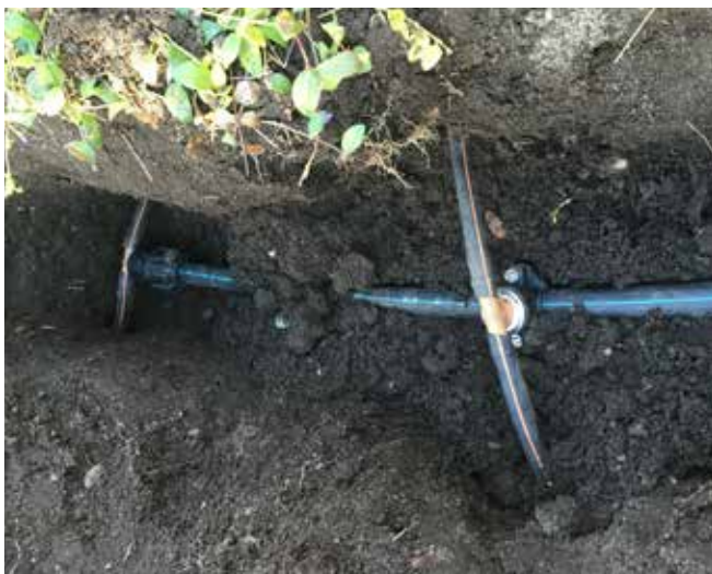
Nedgrävd droppbevattning, Mora
