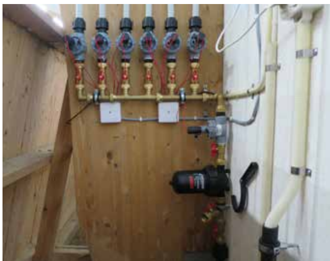
Ventilarrangemang till ridhusbevattning
