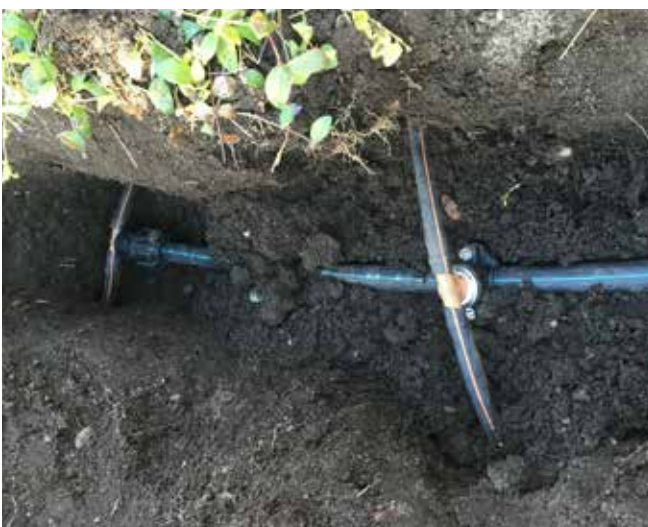
Nedgrävd droppbevattning, Mora
