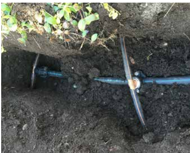
Nedgrävd droppbevattning, Mora
